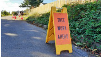
Crews cleared trees and brush in early October./Los equipos talaron árboles y maleza a principios de octubre.
